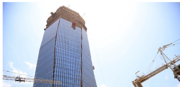
« Tour F », gratte-ciel de 400 mètres et 76 étages en construction dans la commune du Plateau.
