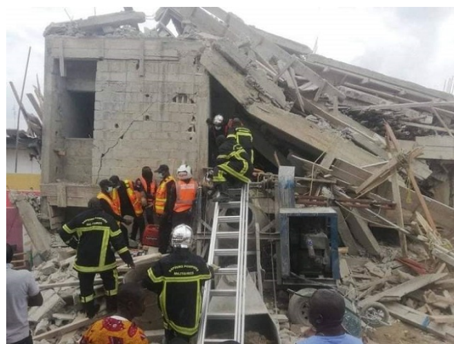
Des immeubles en construction qui s'écroulent deviennent de plus en plus fréquents en Côte d'Ivoire.
