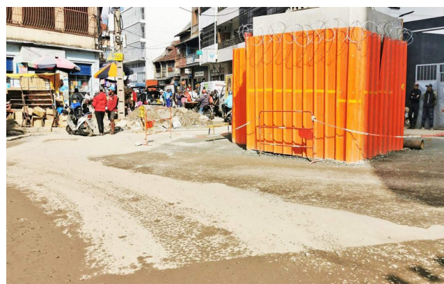
Emplacement d'un futur pylône dans le quartier de Tsaralalàna, à Antananarivo, pour la réalisation du téléphérique dont les travaux ont débuté en mars 2023.
