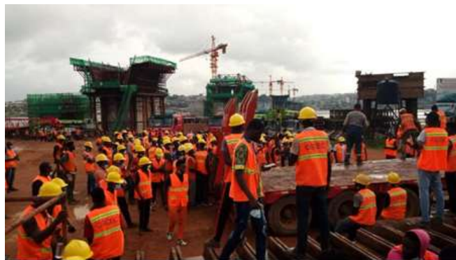
Rassemblement des ouvriers du chantier du quatrième pont d'Abidjan lors d'une journée de grève, le 20 octobre 2020. (Photo DR)
